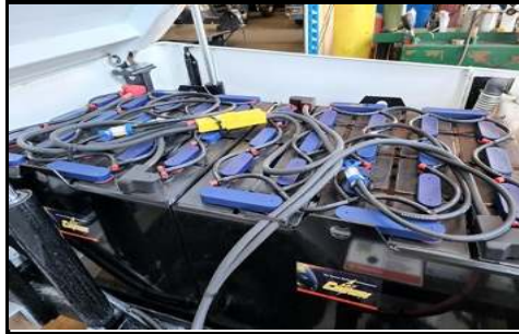
Ensemble de batteries et câbles
