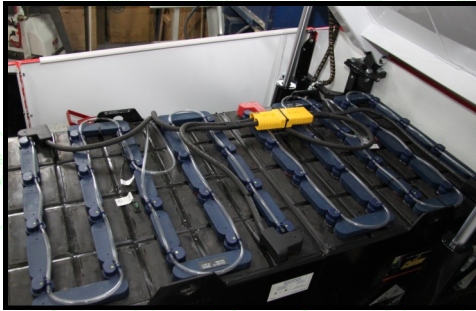
Ens. de batteries et câbles
